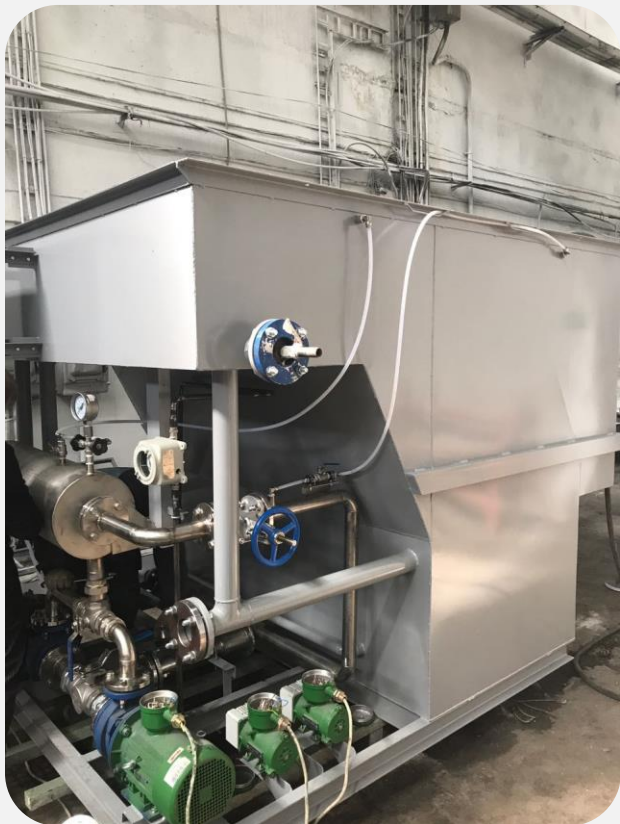
Флотационная установка TEREK-5B взрывозащищенное исполнение Заказчик: АО «Транснефть-Сибирь» Тюменская БПТО и КО Производительность 5 м 3 /час
