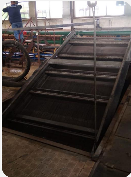
Грабельная решетка BAYKAL Заказчик: АО «Тулагорводоканал» Тульская область Пропускная способность 9000 м3/час.
