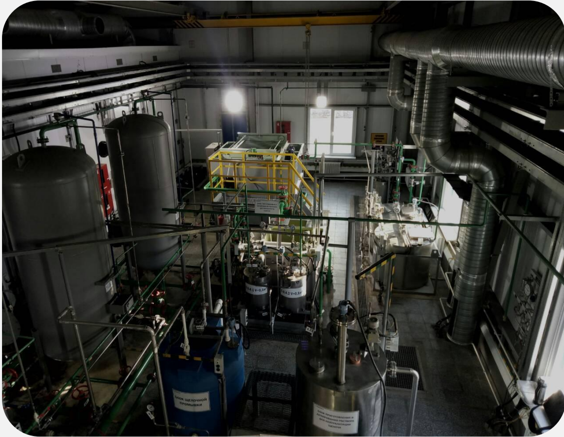
Станция очистки производственно-дождевых сточных вод. Заказчик: АО «Транснефть-Приволга» Самарское РНУ. Производительность 10 м 3 /час
