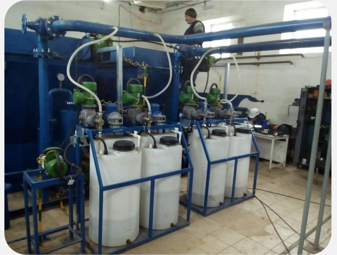
Станция очистки промливневых очистных сооружений. Заказчик: АО «Транснефть-Прикамье» ЛДПС Лазарево. Производительность 3 м 3 /час
